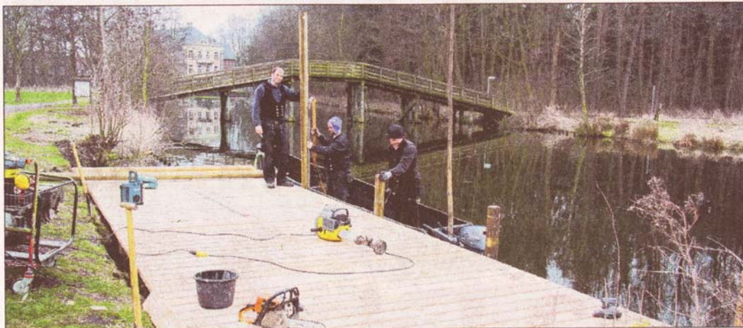
Zimmerermeister Florian Siebold, Auszubildender Thorben Buhre und Geselle David Schadbolt von der Firma Buhre aus Steinhude beim Neubau der Boots- und Kanuanlegestelle.
