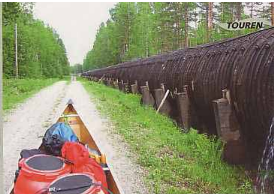
Lange Rohrleitungen versorgen Kraftwerke mit Kühlwasser.
